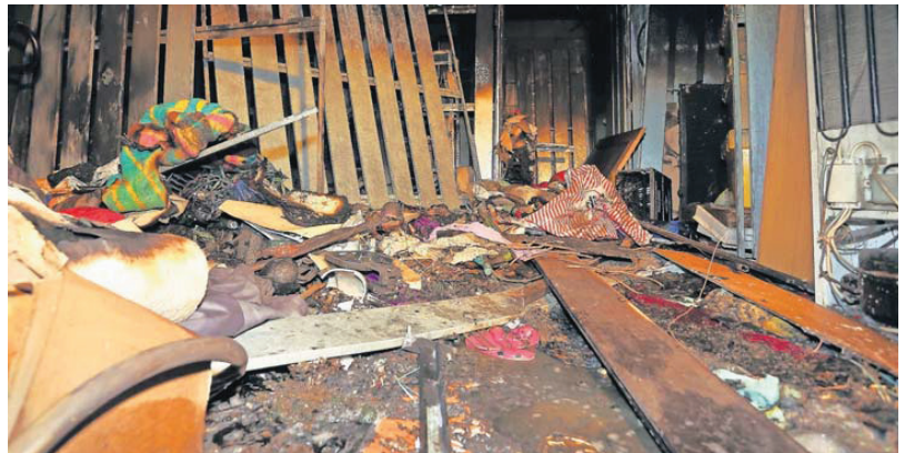
Im Keller des Hauses Sterntaler Weg 59 hat das Feuer in der Nacht gewütet, danach sind die Ausmaße zu erkennen.
